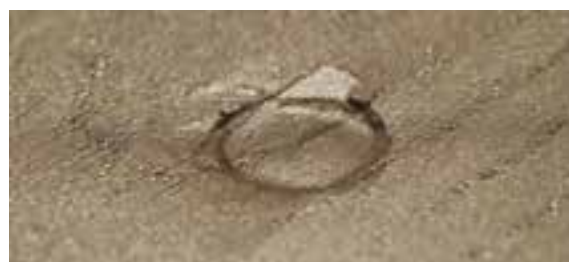
Twardość deski warstwowej – mocne uszkodzenie powłoki lakierniczej oraz warstwy drewna.
