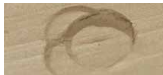
Twardość deski sosnowej – bardzo mocne uszkodzenie powłoki lakierniczej, dewastacja warstwy drewna.
